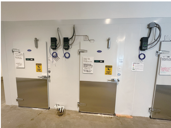
図27 館内の大型冷凍庫
