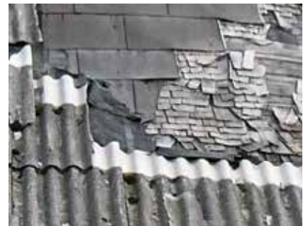
図7 空き家の屋根破損部から見た桁葎（柿葎）屋根（旧豊原）
