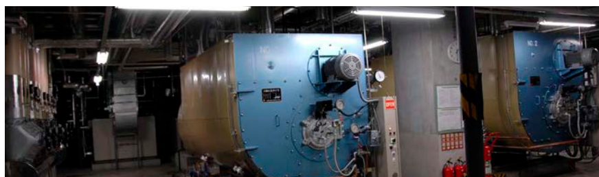
機械室 温湿度管理のための大きな機械が並ぶ
